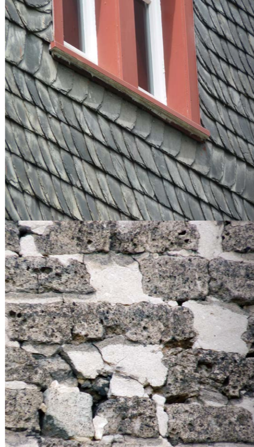
Einfluglöcher unter einer Schieferverkleidung im Bereich unter der Fensterbank und in einer Mauer, die jeweils von der Zwergfledermaus genutzt werden (Quelle: M. Straube)
